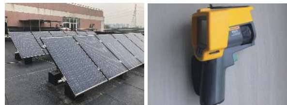
图 6 光伏组件与热像仪
