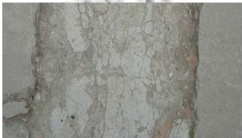
图 6 实际破损路面
