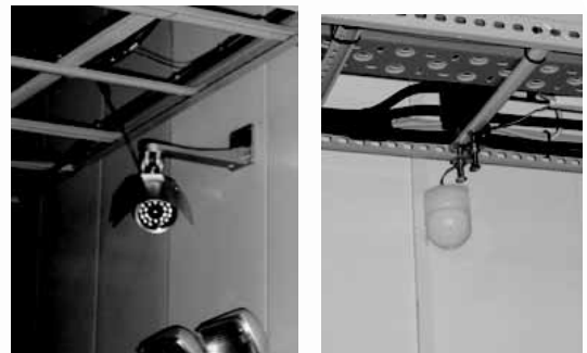
图 7 现场安装实物(左摄像头 右人体红外传感器)
