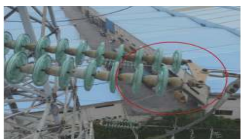
图8 部分巡检缺陷图
